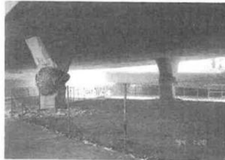
写真 5.5.28 LP3-1 橋脚の被害 (曲げせん断破壊) 2)
