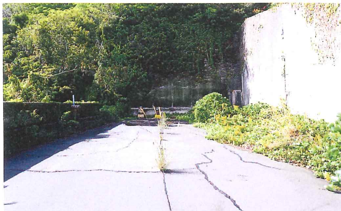
地滑りによってひびが入り、埋められた旧名取トンネル。国道はトンネルが多い。愛媛県伊方町。2015年11月2日
