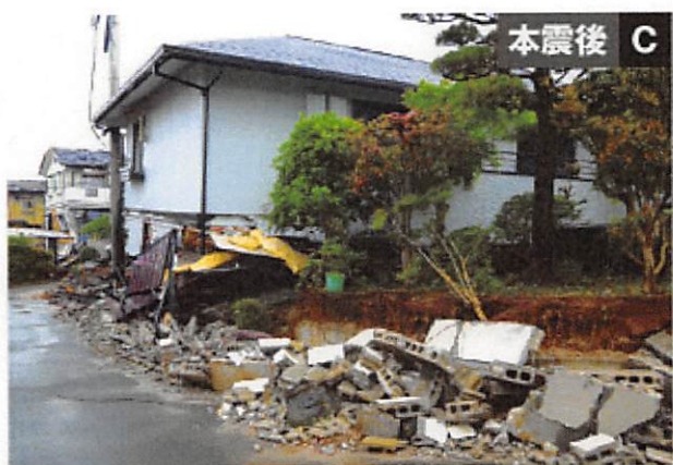
本震で1階が崩壊したプレハブ住宅（写真：日経ホームビルダー）
