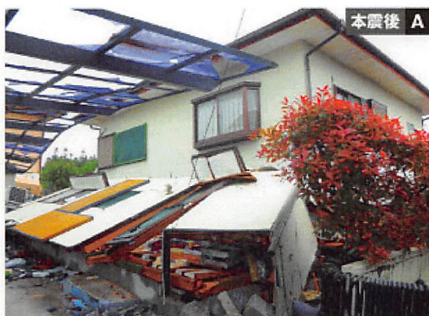
本震で1階が崩壊。基礎の隅部は損壊している。木造軸組工法の住宅だ。2階部分は、隣の住宅Bの車庫に止めてあった自動車にぶつかっていた（写真：日経ホームビルダー）
