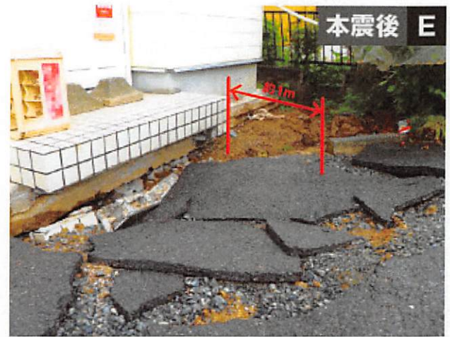
住人によると、玄関ポーチは以前、右側に見える縁石のようなものに接していた。地震動の影響で、住宅が基礎ごと1mほど西側に動いたという（写真：日経ホームビルダー）
