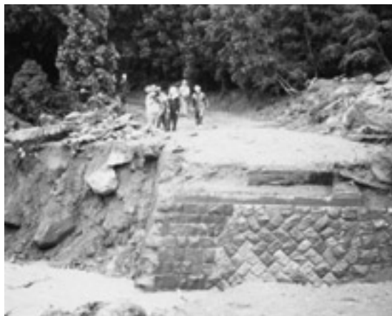
写真6 土石流により流された水無川にかかる平原橋。わずかの火山灰、わずかの降雨で土石流は発生しました。1991年5月19日撮影。
