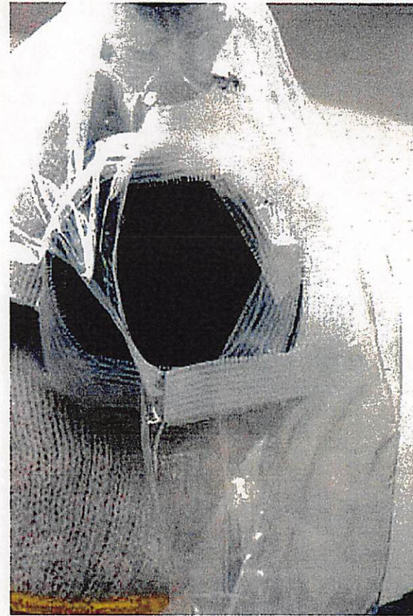
写真⑤ 外側養生テープ剥がれ
