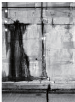
図 19 旧名取トンネルにおける損傷
