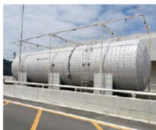
② 重油タンク
