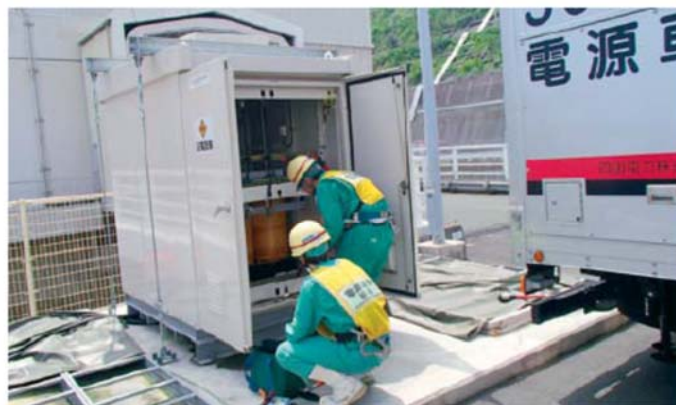
電源車から建屋への給電訓練
