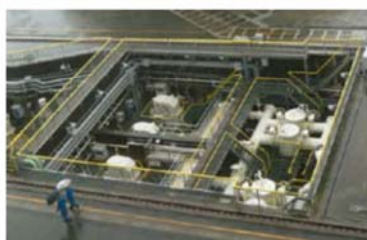
海水ピットポンプ室 (飛来物対策前)
