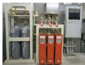
自動消火装置 (ハロン消火装置)
