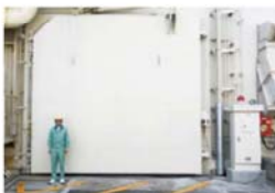
大型水密扉 (扉の厚さ35cm)
