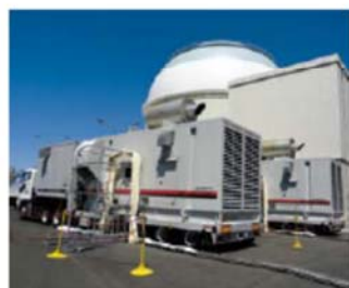
① 空冷式非常用発電装置
