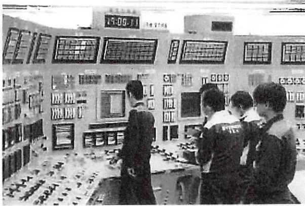
関西電力高浜原発3号機の再稼働に向け、機器を操作する同電力社員（左）＝同号機の中央制御室で2016年1月29日午後5時（代表撮影）
