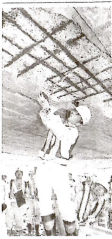
橋の下面の劣化部点検方法を教わる者ら—26日午後、中央市寒川町
