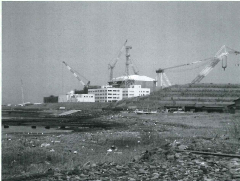
青森県の下北半島にある大間原発(建設中)。対岸の函館市などの市民が大間原発建設・運転差止等を求める訴訟を展開しており、今年に入って函館市も同様の提訴を行った。同原発は、使用済燃料の「有効利用」を図ったフルMOX型の商業用原子炉だが、これは世界的にも例がない。一方、青森県や福井県などの原発立地では、自治体財政や雇用の面で原発等に依存する構造が形成されてきた。
