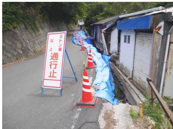
伊方町釜木の路肩崩落現場
